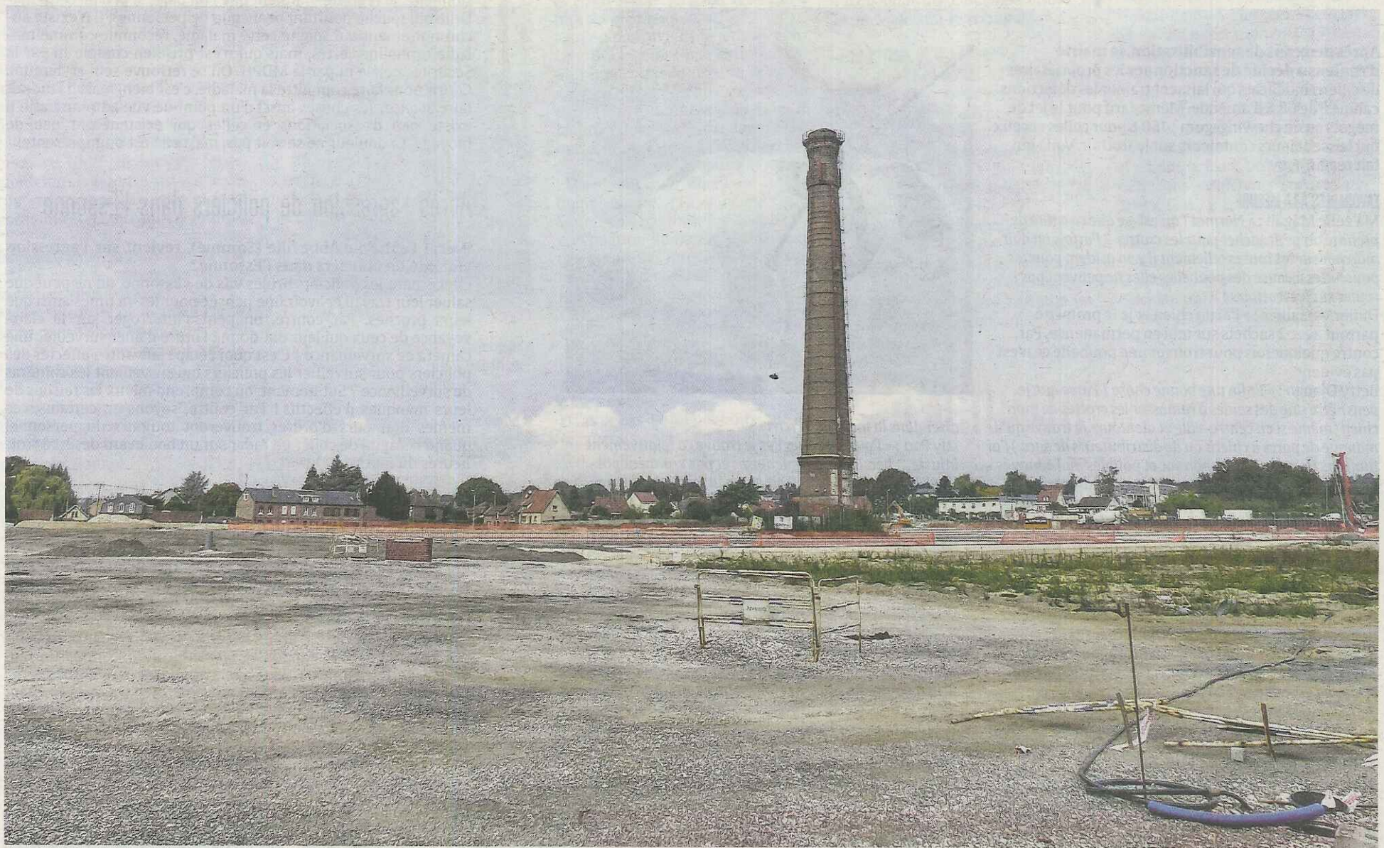
Sur le site de l'ancienne sucrerie d'Abbeville, Burger King est attendu après l'été 2017. Soixante-dix postes, dont soixante équipiers et dix managers seraient ainsi à pourvoir pour cet établissement de restauration rapide.
